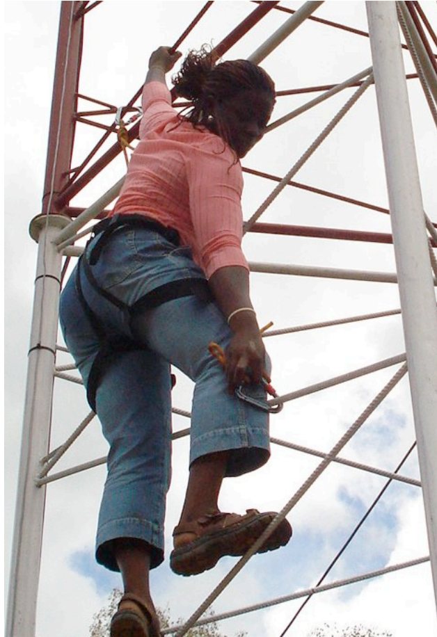
Figura 11.3: Omolayo Samuel, una de las empleadas de Zittnet, no muestra miedo a la altura en la torre de 45 m cuando alinea las antenas colocadas en el tope de la torre.
