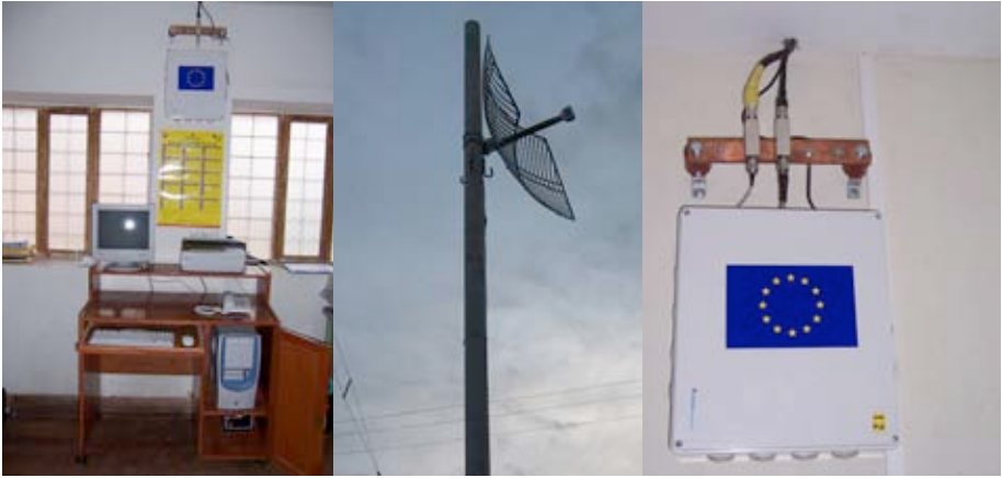
Figura 11.32: Acopia . De izquierda a derecha: Estación de cómputo y caja de equipo de telecomunicaciones; antena de 24dBi montada en poste de 6 metros; y caja de equipo de telecomunicaciones.
