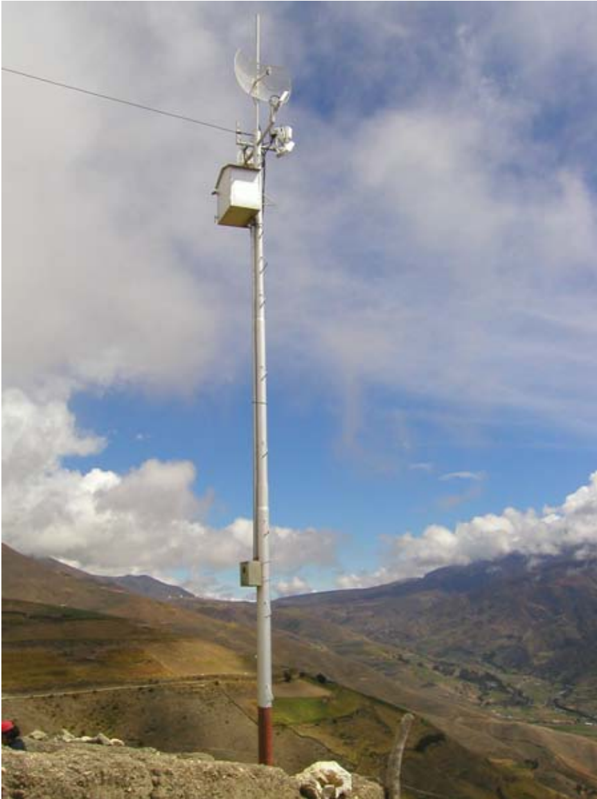
Figura 8.3: Una torre autosoportada sencilla.
