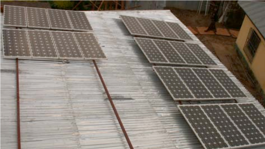
Figura 11.1: Se montaron 24 paneles solares con una potencia nominal de 80 W en el techo del NOC para proporcionar energía 24/7 al sistema.
