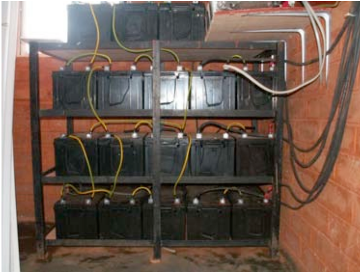
Figura 7.9: Un banco de baterías de 3.600 Ah. La corriente alcanza niveles de 45 A durante la carga
