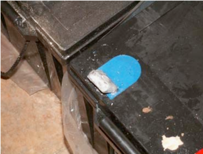
Figura 7.2: Batería de plomo-ácido de 200 Ah. El terminal negativo está roto por haberle aplicado todo el peso durante el transporte de la batería.
