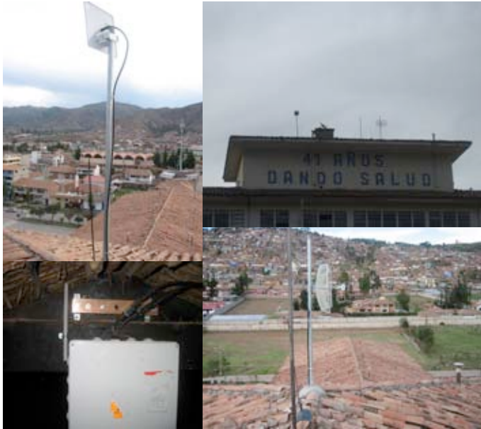
Figura 11.28: Hospital Cusco . De izquierda a derecha y arriba abajo: Antena direccional de 19dBi apuntando a la Red Sur; antenas montadas en tejado; caja de equipos montada en el interior del tejado y antena direccional de 24dBi apuntada al repetidor Josojahuarina1.
