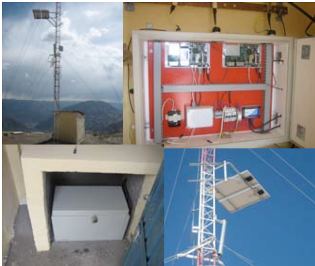
Figura 11.29: Josojahuarina1 . De izquierda a derecha y arriba abajo: Antenas y paneles solares montados en torre ventada de 12 metros; equipos de telecomunicaciones y protección eléctrica en caja metálica; caja metálica de batería; paneles solares montados en la torre ventada.
