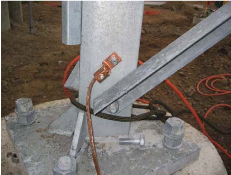
Figure 5.2: Torre con un cable de cobre grueso conectado a tierra
