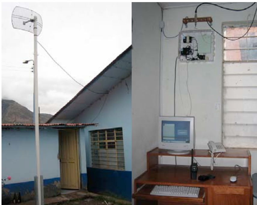
Figura 11.30: Urcos . De izquierda a derecha: Antena direccional de 24dBi montada en poste de 6 metros; estación de cómputo y equipo de telecomunicaciones en Urcos.
